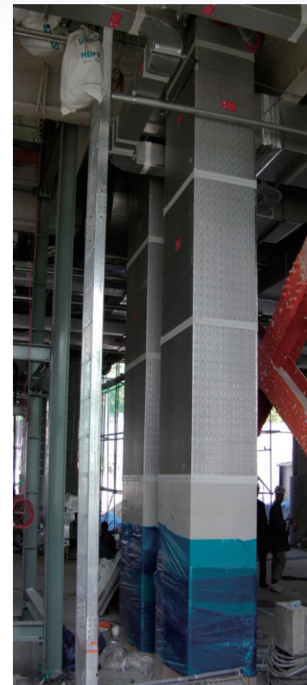
直管ダクト接続の姿
